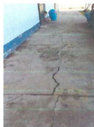
Foto 2: Estado actual del piso del corredor de la escuela, lo que representa peligro para los niños, lo que se requiere su mejoramiento.
