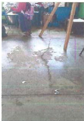
Foto 1: Estado actual del piso de las aulas por lo que se requiere mejoramiento
